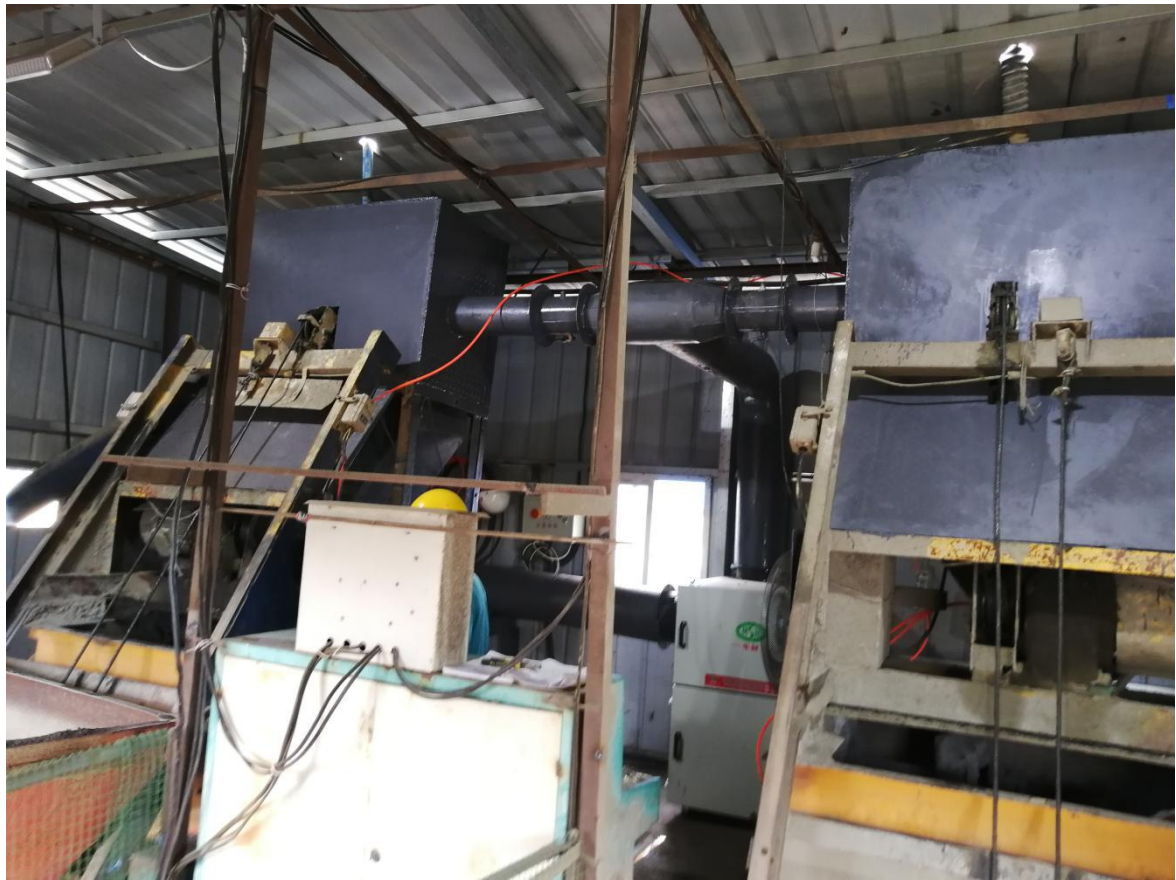
图 6-1 搅拌机除尘系统
