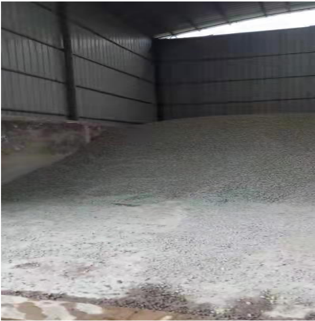
峨米段八标混凝土拌和站原料堆场
