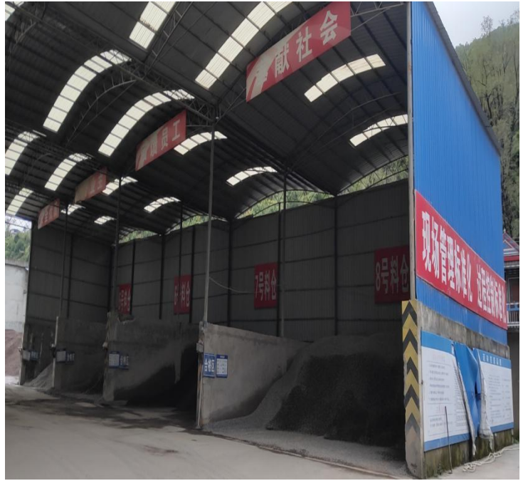
峨米段八标混凝土拌和站原料堆场
